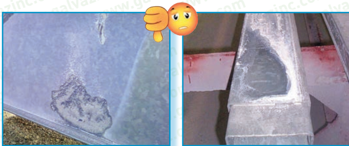
Photos 67 et 68 : Les sels de zinc blancs (taches de stockage humide)
